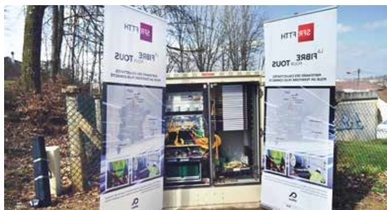
Déploiement du Très Haut Débit
